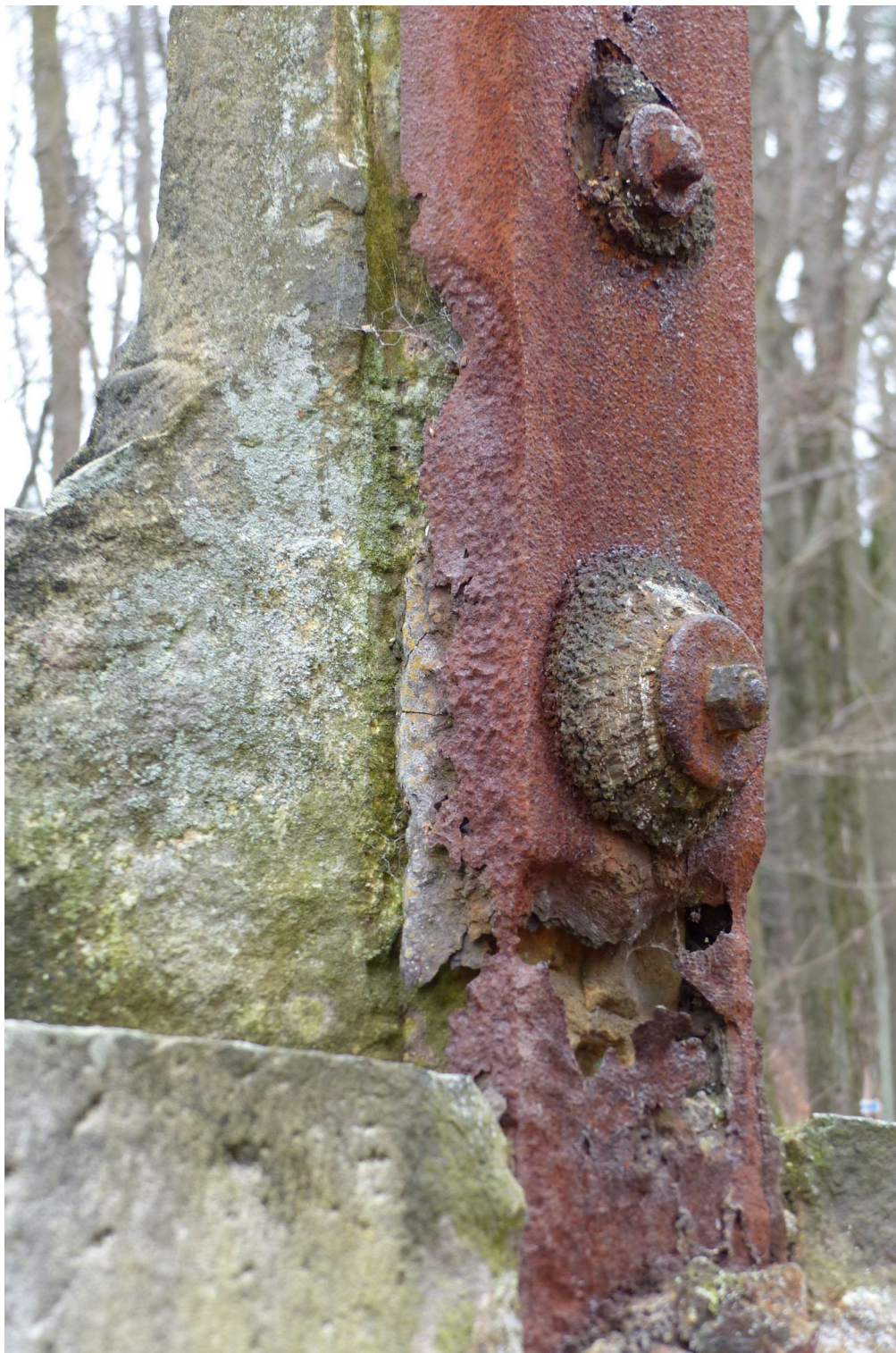
Detail místa kde koroze narušila statiku železného kříže.
