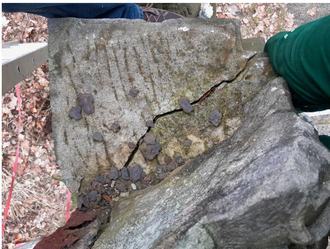
Prasklina způsobená korozí železa. Tyto praskliny byly překryty krycí plachtou.
